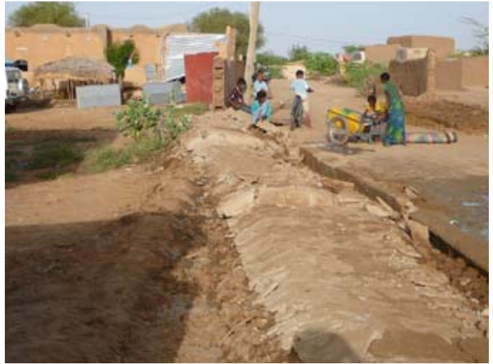
Le mur d'enceinte le long de la rue et la maison du gardien effondrés Au fond la médiathèque et son mur d'enceinte en béton qui n'ont pas été touchés
