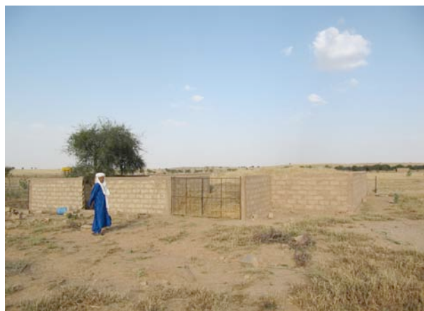
Une aire de stockage à peine terminée commence à se remplir d'herbe fauchée
